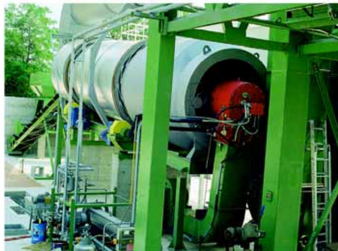
Горелки мод. PYR 7 GNR (11.160 кВт) Работает поочередно на газе и мазуте повышенной вязкости. Установлена на сушильной печи для инертных материалов мощностью 11.000 кВт на предприятии фирмы Adria Beton (г. Асколи Пичено).
