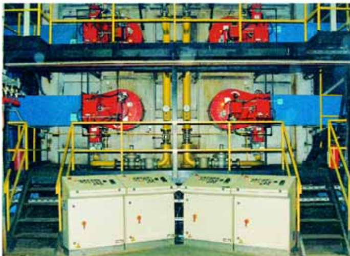
Горелки мод. PYR 7 GNR (11.160 кВт) Работает поочередно на газе и мазуте. Установлена на котле с водяными трубами мощностью 60 т/час на нефтеперерабатывающем заводе Darmanseti (Румыния).
