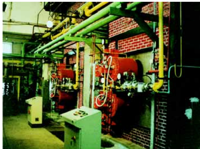
Горелки мод. PYR 5 GN RAC (6.140 кВт) Работает поочередно на газе и мазуте. Установлена на котле с водяными трубами 2х10 т/час, на предприятии Derolever (Италия).
